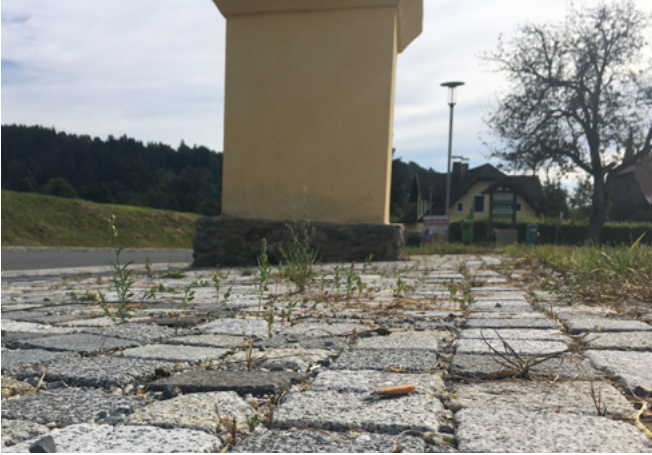
Unordentliches Ortsbild durch Unkrautbewuchs
