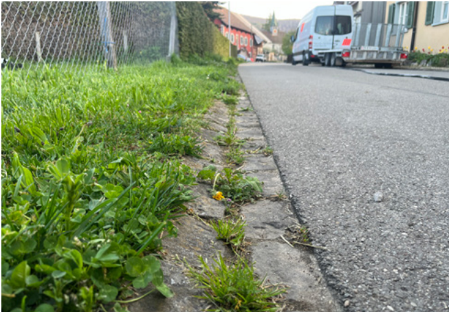
Verwachsenes Fugenbild vor der Sanierung
