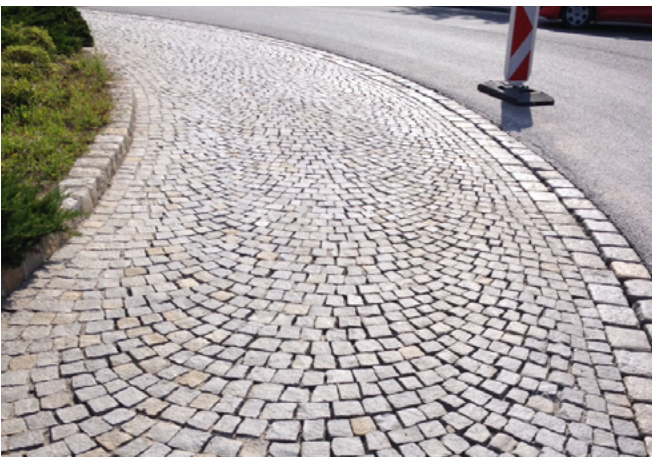
Leere Fugenkammern führen zu Schäden
