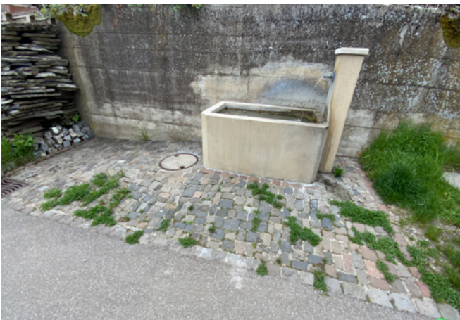
Verwittertes Fugenbild vor der Sanierung
